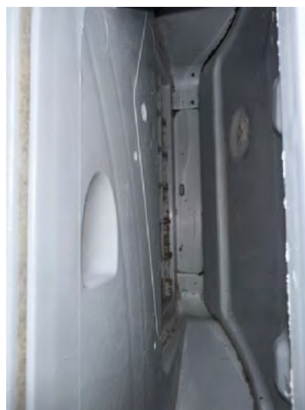
PJ 1 - à gauche au fond en bas la grille situé derrière les 3 filtres, et donnant sur le condenseur
