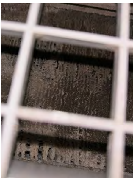
PJ 1 - Photo de l'état du condenseur
